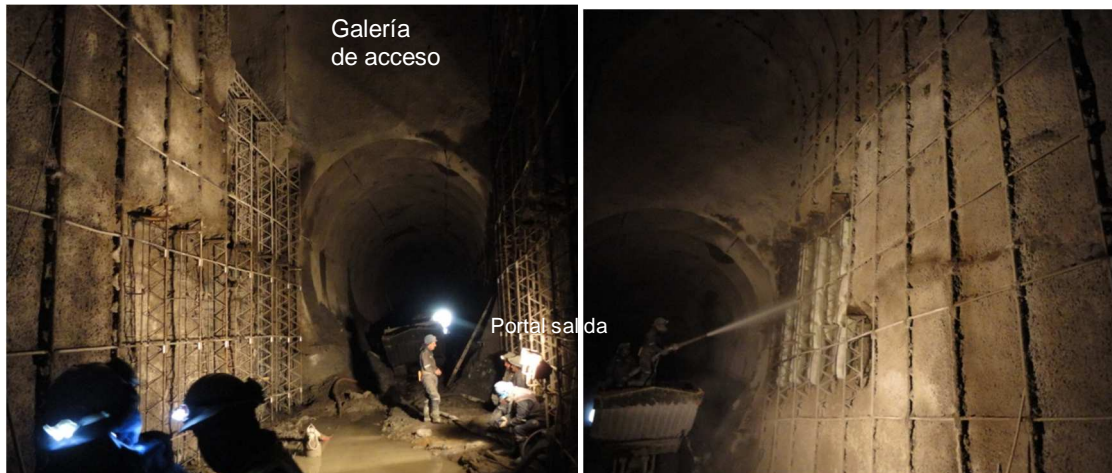
Foto N°18.- Sectores de hastiales que deben ser rel lenados con hormigón lanzado
