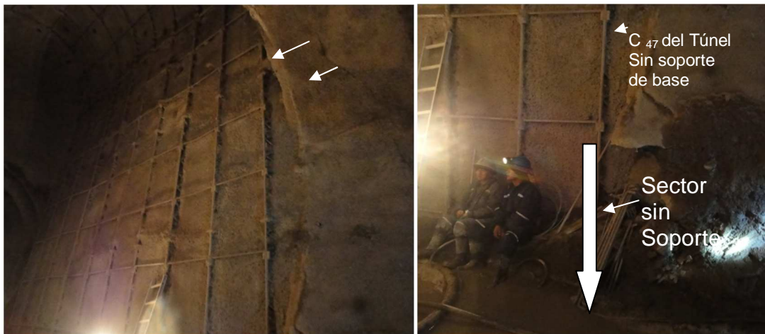
Foto N°19.- Fisuras en hastial derecho proximo a 1a cercha - Cercha sin soporte en base
