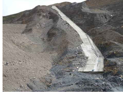
Foto 6: Estado actual del plinto derecho
