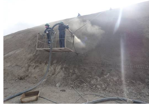
Foto 2: Malla electrosoldada cubierta por hormigón proyectado
