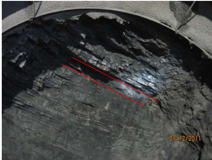
Foto N°17.- Frente alterado, con pliegues fracturados
