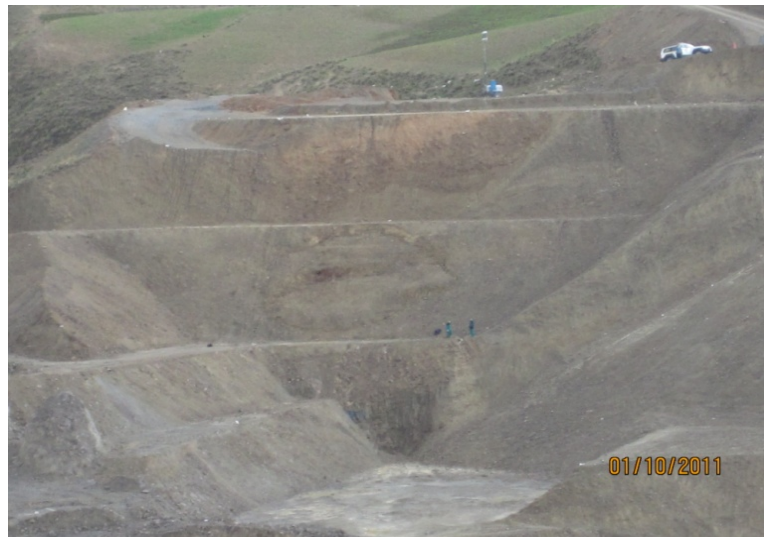
Foto N° 16.- Asentamiento en Banquina Próximo a Eje de Plinto
