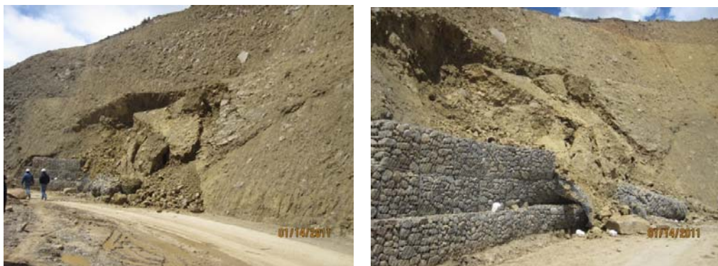
Foto N°15.- 2do Desprendimiento en la 3782
