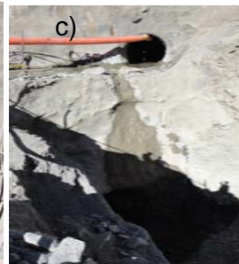
c) Rebalse de agua hacia el Portal del Túnel
