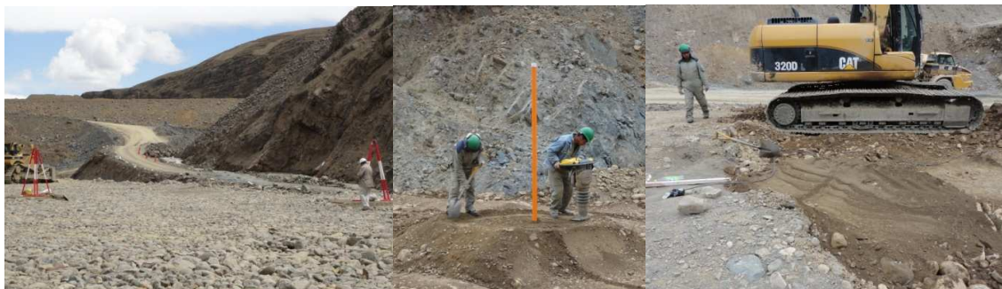
Foto N°36.- Instrumentos instalados en relleno de Presa
