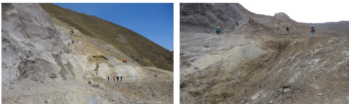
Foto N°30.- Nuevo asentamiento y cuña luego del retiro del material
