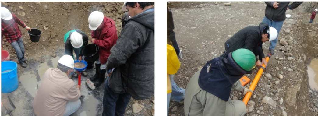
Foto N° 37 Medidores de Asentamientos
