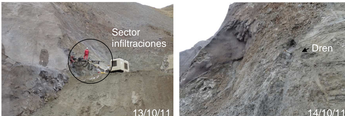
Foto N°28.- Sitio de filtraciones y perforación para drenes
