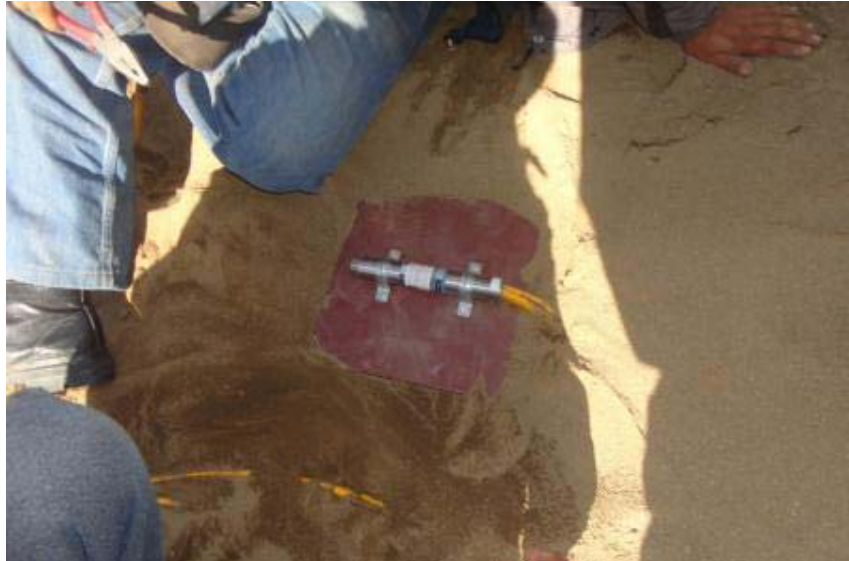
Celda Eléctrica de Hilo Vibrante instalada en la cota 3705.00
