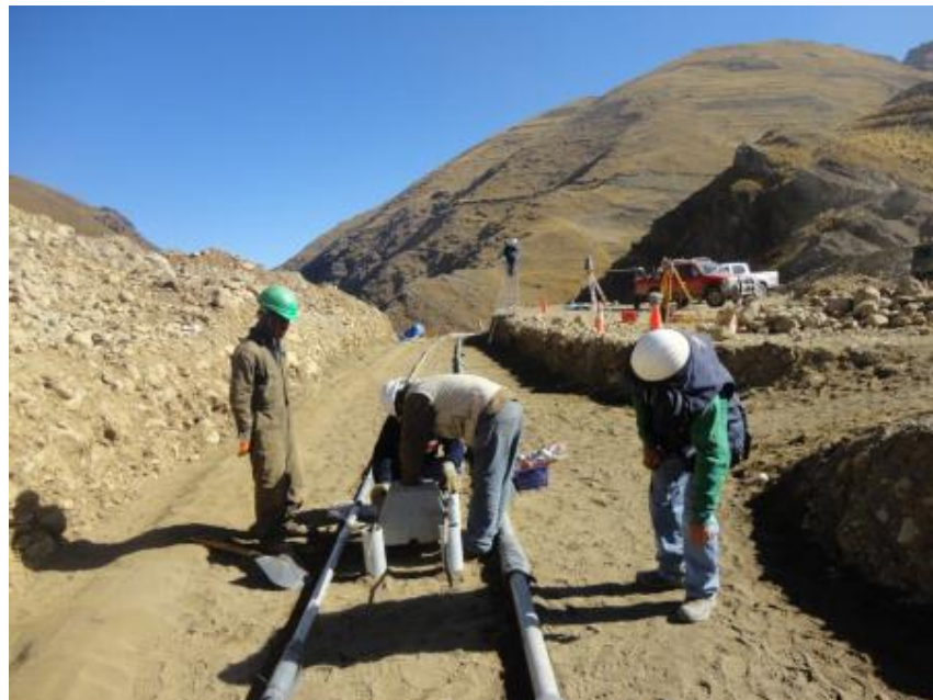
Celda hidráulica instalada en la cota 3705.00
