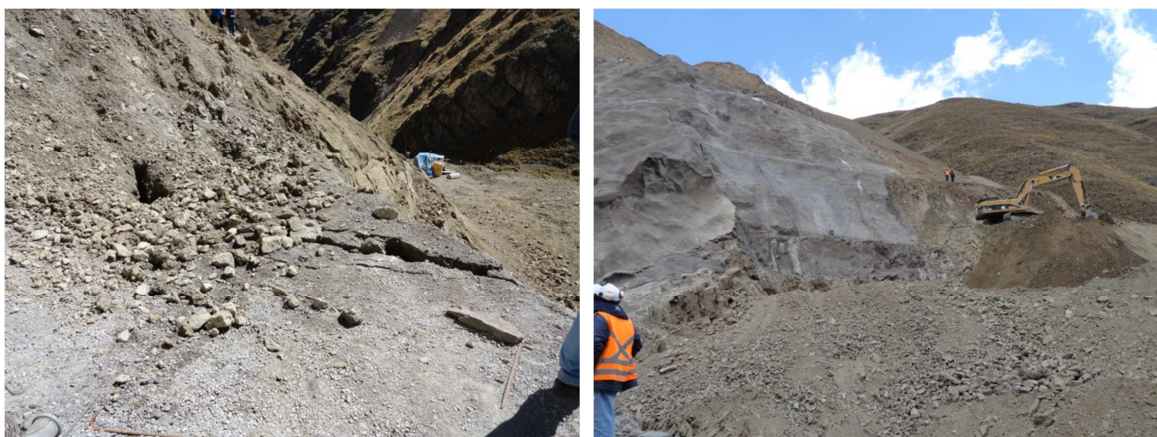
FotoN°37.- Fisuras luego del asentamiento y retiro del material suelto
