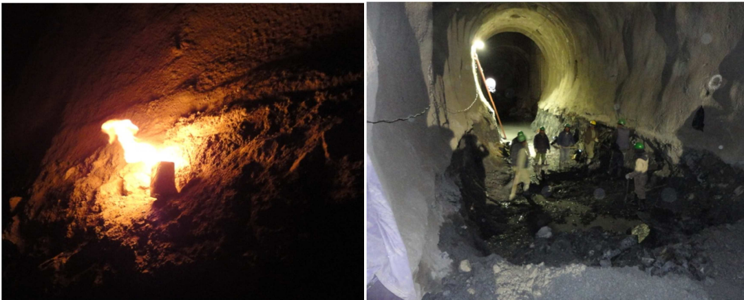
Foto N°13.- Iluminación del Túnel luego del retiro de las instalaciones de IESA
