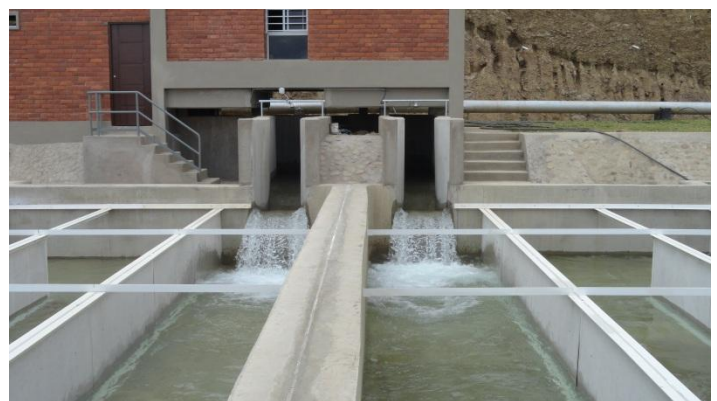
Planta de Tratamiento en prueba de operación
