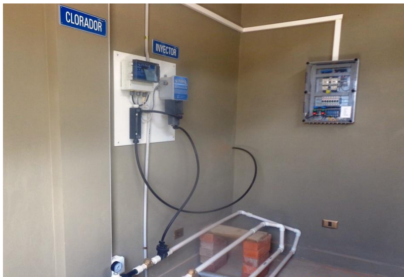
Sala de cloración
