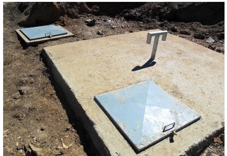
Tanque de 7 m 3
