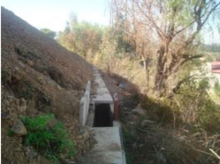
Canales de riego afectados que fueron mitigados
