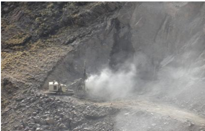
Excavación en roca por voladura en el camino de acceso a la galería
