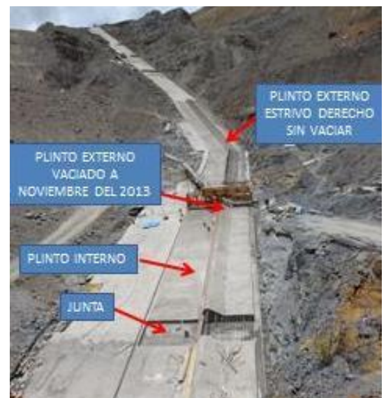
Plinto Central y Plinto Derecho
