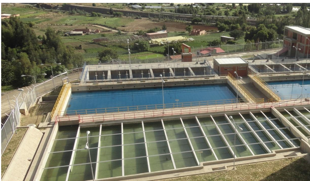
Unidades de tratamiento - Planta de Tratamiento Misicuni
