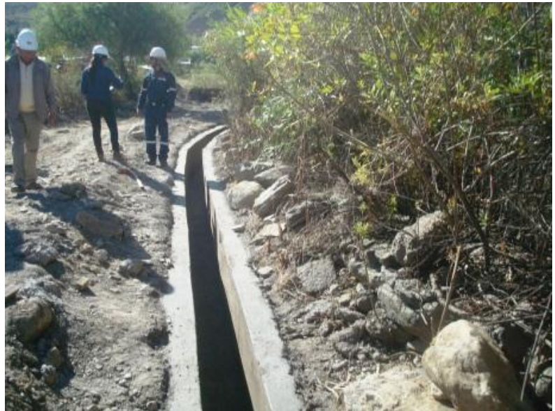
Canales de drenaje para la limpieza de filtros
