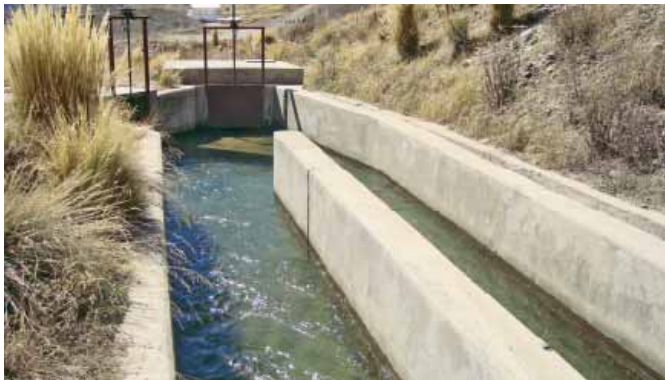
Ingreso de caudal para distribución obra de toma Misicuni
