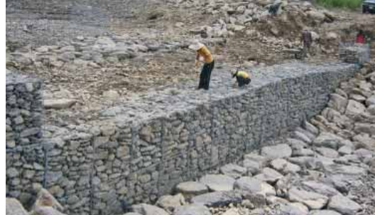
Emplazamiento del vertedero de gaviones en lecho del río Pihusi
