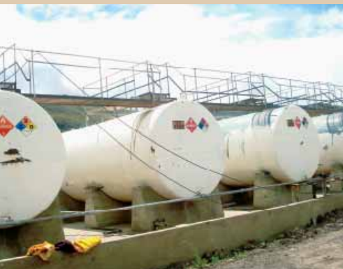
Almacenamiento de combustible
