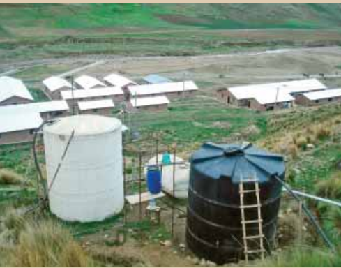
Tanque de agua con sistema de cloración
