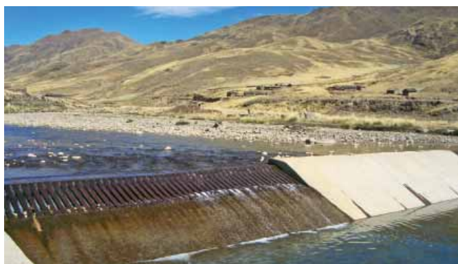
Obra de toma Tirolesa Misicuni
