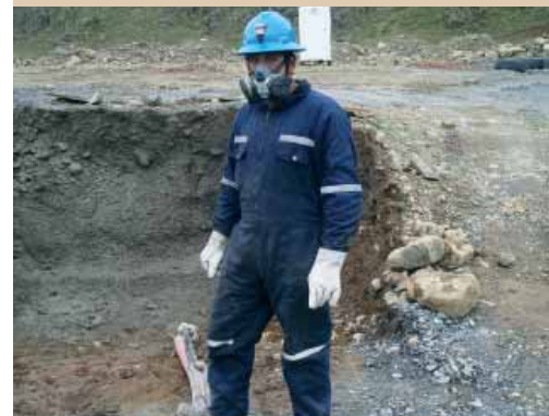
Uso de epp's por parte del personal
