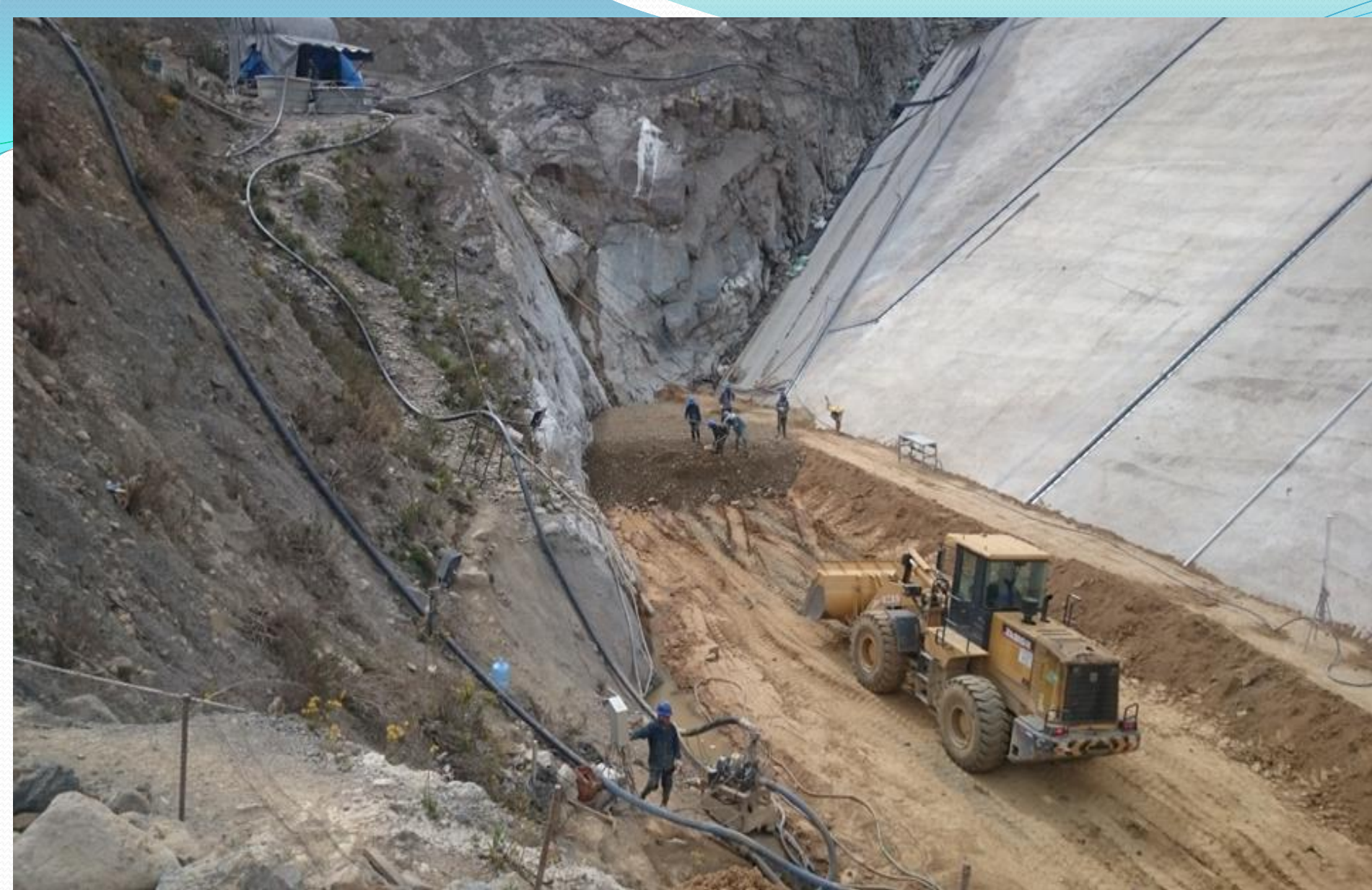
RELLENO DE MATERIAL SOBRE CARA DE CONCRETO
